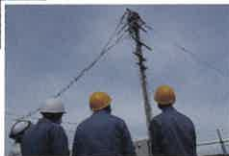
27日AM 太陽光発電所 年次点検
