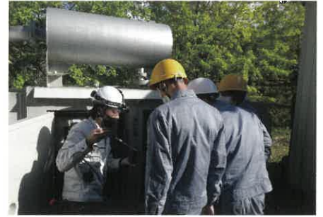
26日PM 月次点検 非常用発電機
