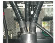
高圧CVケーブル
