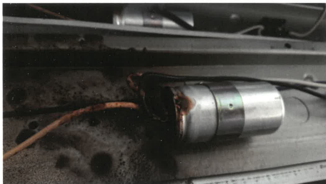
破裂した器具内の部品のMPコンデンサー
